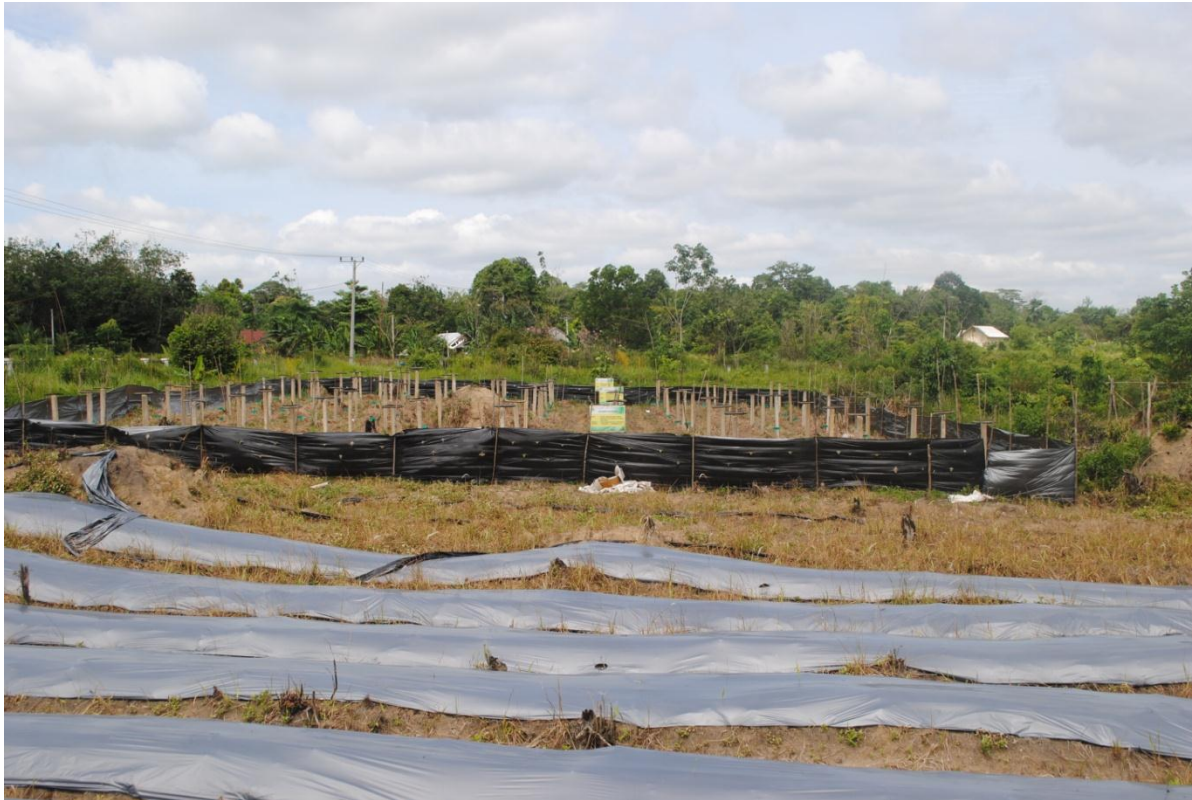
Foto 11. Kondisi Setelah Kajiwidya
